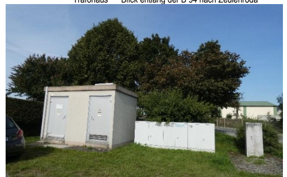
Trafo- und Anschlusskästen der Energiewerke in ungeordneter Aufstellung
