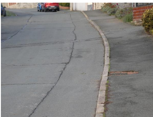
Straßenschäden im rot markierten Bereich
